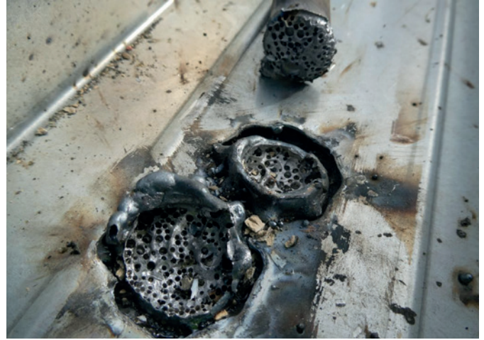
▲ Bild 9. Misslungene Schweißungen bei einem Spalt zwischen Blech und Träger
