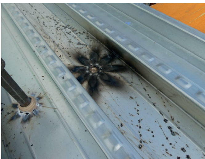
▲ Bild 6. Versuch einer Schweißung durch ein Profilblech auf einen beschichteten Obergurt
